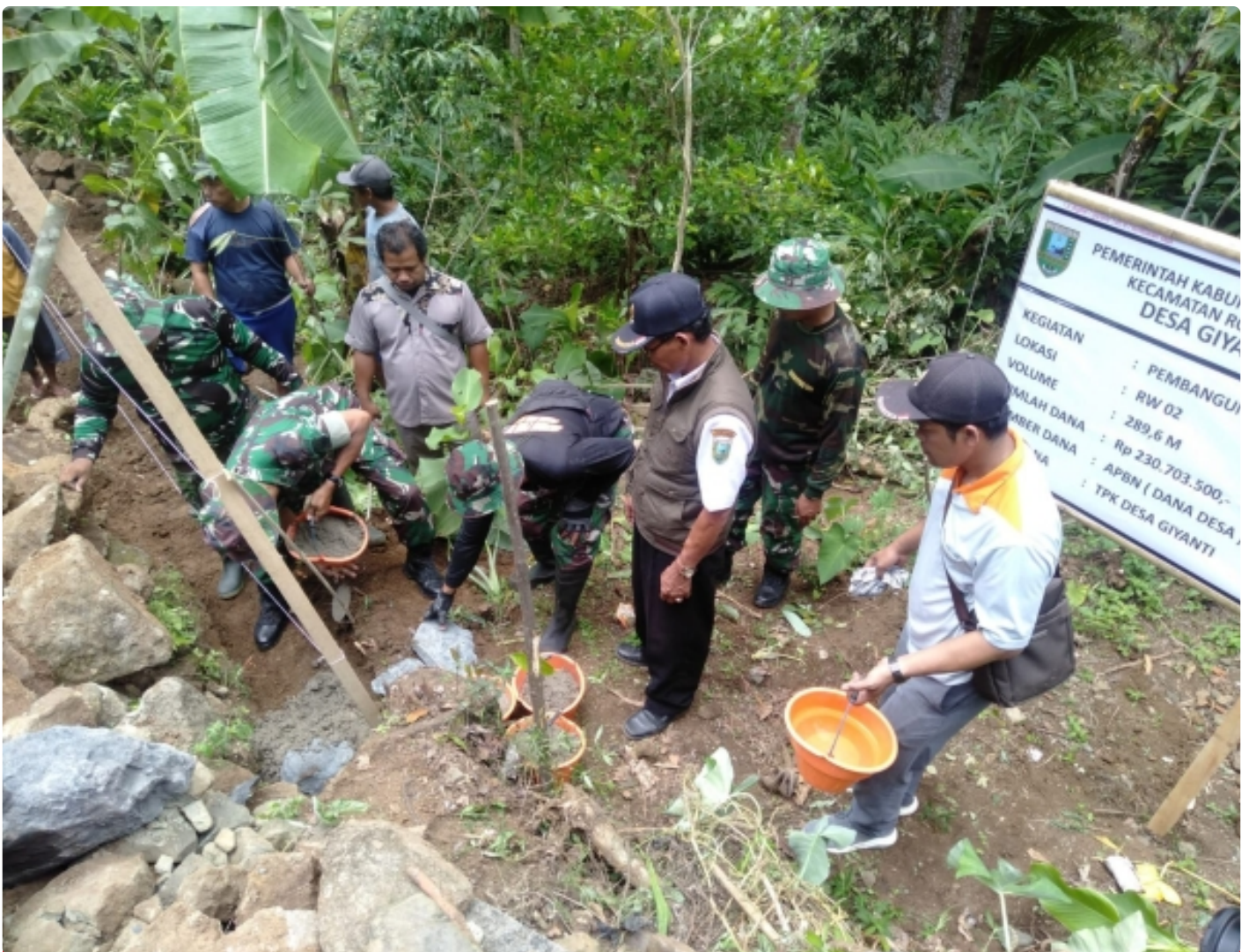
Peletakan batu pertama Pra TMMD Sengkuyung Tahap III di desa Giyanti kecamatan Rowokele, Kabupaten Kebumen, Provinsi Jawa Tengah
